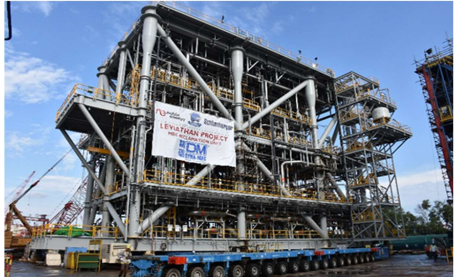
MEG Reclamation Unit
